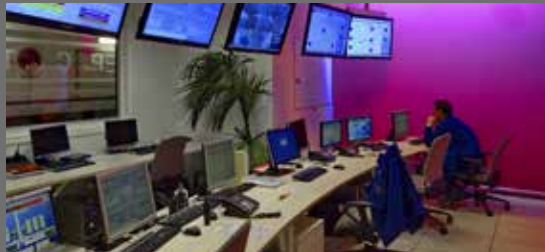
La Réalisation du Poste de Contrôle Technique du Data Center de la Société Générale de Tigery , France.
